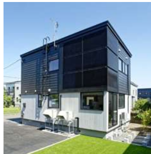
壁面設置の太陽光発電
